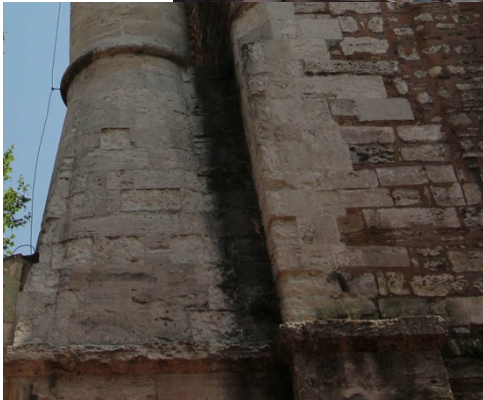
Taş-tuğla yüzeylerde kısmi yüzey kayıpları
