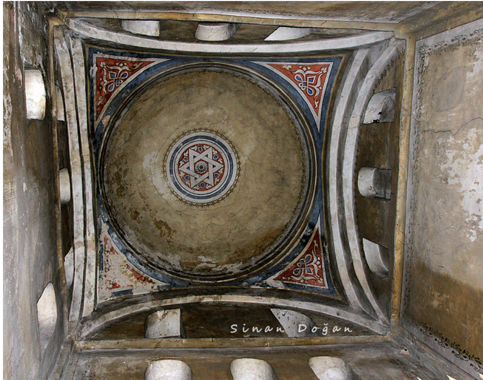
KUZEY KÖŞE KUBBE KILCAL ÇATLAKLAR VE SIVA - BOYA DÖKÜLMESİ
